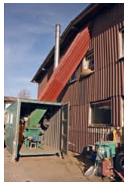
Bild 1: Container mit Heuverbrennungsanlage.
