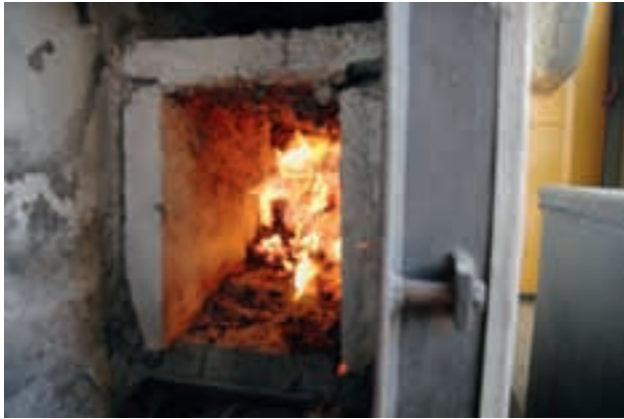
Bild 2: Blick in Brennraum der Heuverbrennungsanlage.
