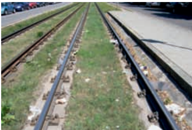
Abb. 8: Tiefliegende Gleise als Müllfänger (Bild: Besier, 2010).
