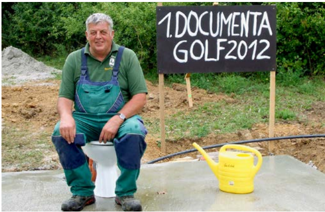
Werner Weybrecht „dokumentiert“ den Baubeginn zweier massiver WC-Häuschen und nimmt schon mal Platz.
