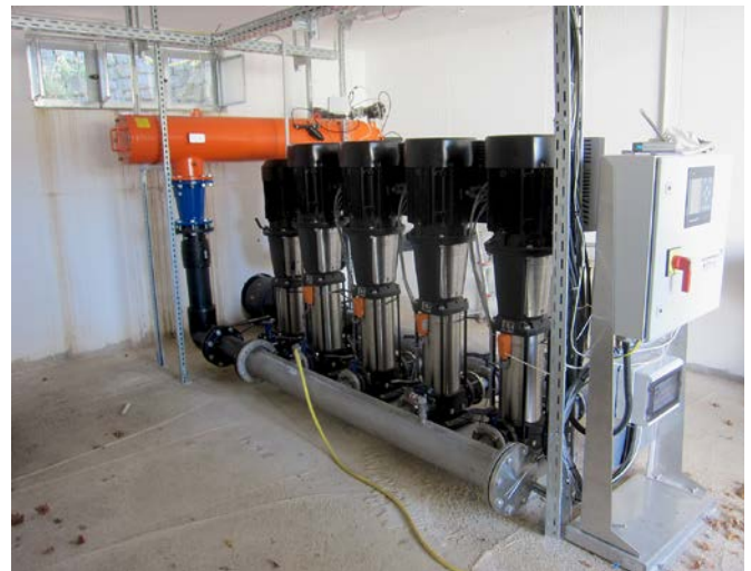
Moderne Pumpenanlagen sind ökologisch sinnvoll und aufgrund ihrer Effizienz auch wirtschaftlich überlegenswert. (Foto: STOCK Beregnungstechnik)
