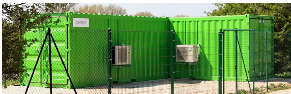
Die Wasseraufbereitungstechnik mit Filteranlage, Umkehrosmose-Anlage und Vorlagebehältern wurde als komplett vormontierte Containeranlage geliefert. Eine Containerbauweise kann gewählt werden, wenn kein Gebäude für die Unterbringung der Aufbereitungsanlage zur Verfügung steht. (Bild: Grünbeck/Walter Schnell)
