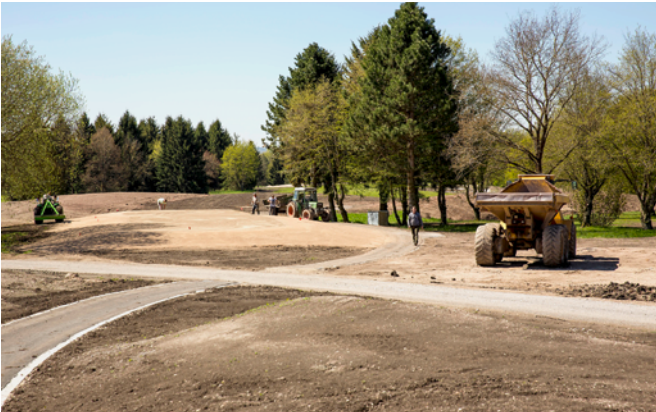
Der Neubau des West Courses steht kurz vor seinem Abschluss. Die Breaks sind fertig ausgestaltet und die Infinity-Regner sind eingebaut.
