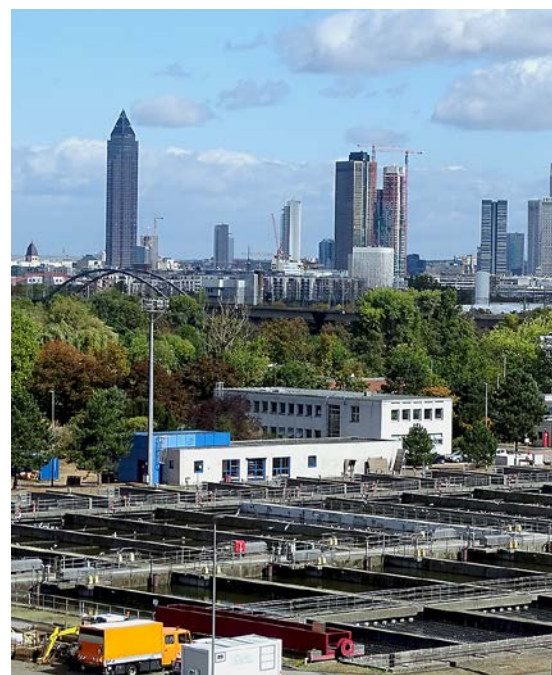
Abb. 4: Ablaufbecken der Kläranlage Frankfurt Niederrad.
