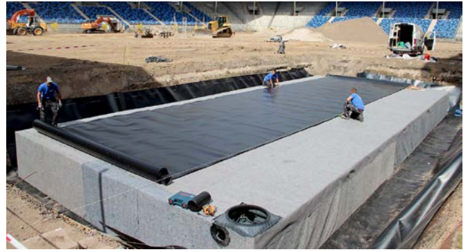
Die innere Schicht wurde in einem zweiten Arbeitsschritt mit einer wasserundurchlässigen 2-mm-HDPE- Kunststoffdichtungsbahn verschweißt.
