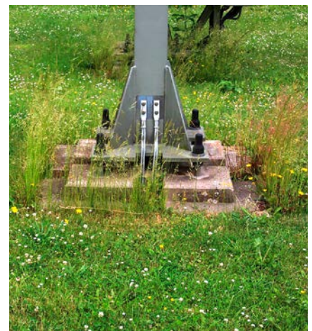
Abb. 5: Kanten von festeingebauten Elementen führen zur Nacharbeit. (Foto: ILOS, 2019)
